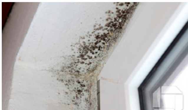
Mygla og raki eru þekkt vandamál hér og landi – rakavarnir eru mikilvæg forvörn þegar kemur að þessu vandamáli.
